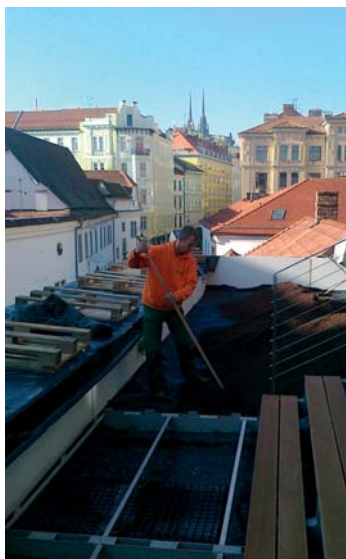
Realizace střešní zahrady na budově nového Divadla na Orlí – JAMU v Brně
